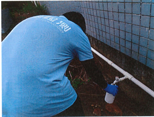
四堡水厂出厂水采样口
